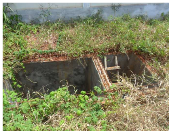
Photo 4: armature des fosses entamées par la corrosion
