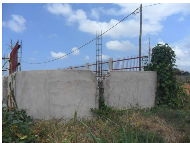
Photo 3: partie de clôture inachevée
