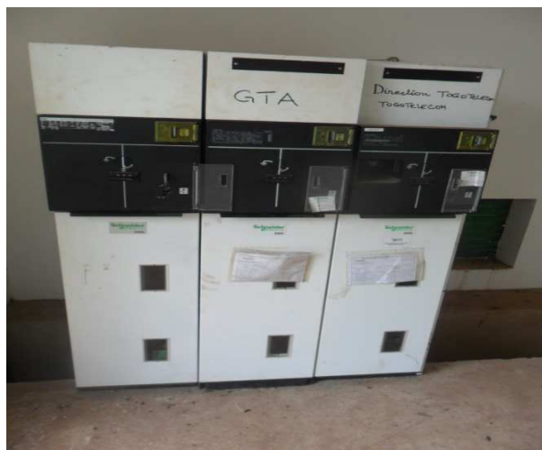
Photo 3: Cellules arrivée / départ du poste de GTA
