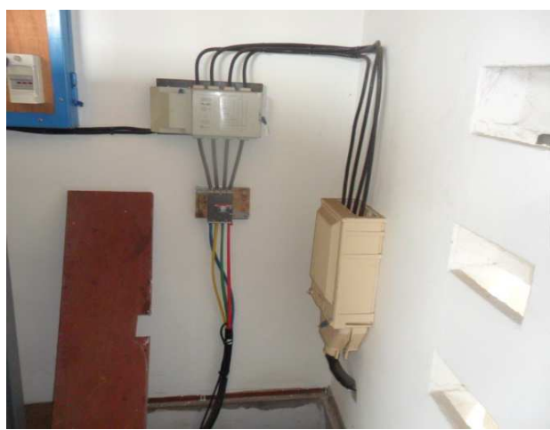
Photo 1: Câble d'arrivée AGE dans un poste à Ablogamé
